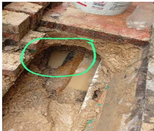
Imagen 14, fuga en tubería enterrada.
