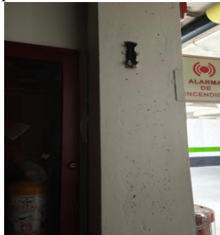
Imagen 7, gabinete con vidrio crudo y sin martillo de fragmentación.
