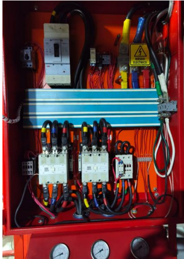
Imagen 13, tablero de control.
