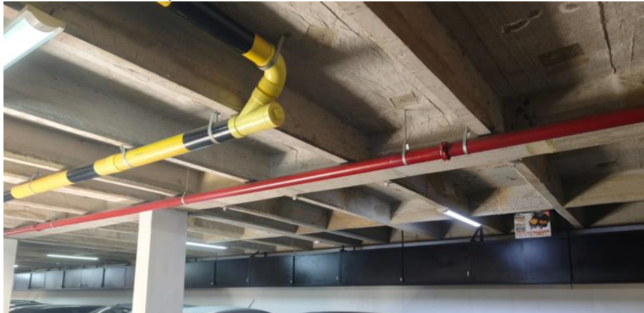
Imagen 2, red sin soportes antisísmicos
