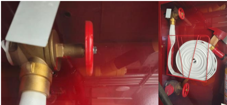
Imagen 5 y 6, válvula sin restricción de presión
