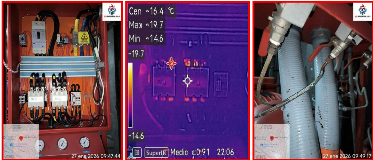
Fotografía: 5 Inspección controlador
