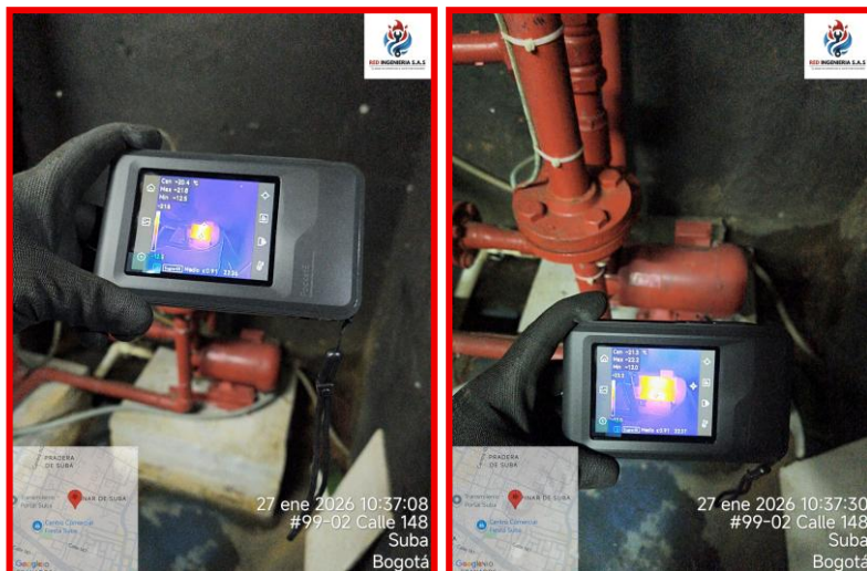
Fotografía: 2 Inspección bomba jockey
