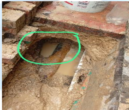
Imagen 14, fuga en tubería enterrada.
