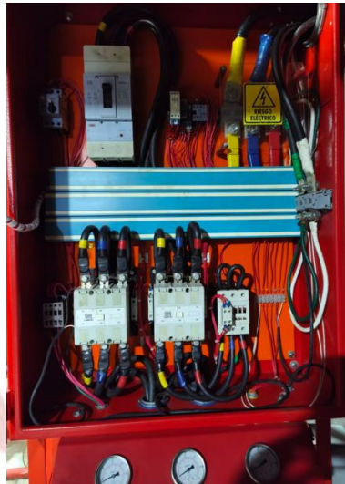
Imagen 13, tablero de control.
