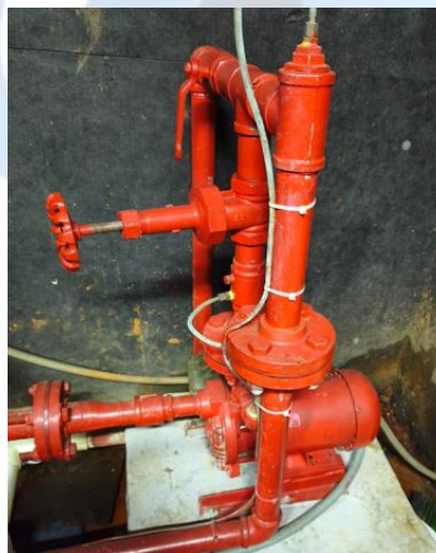
Imagen 10, válvula bomba jockey.
