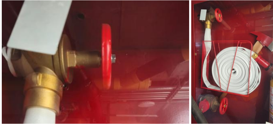
Imagen 5 y 6, válvula sin restricción de presión
