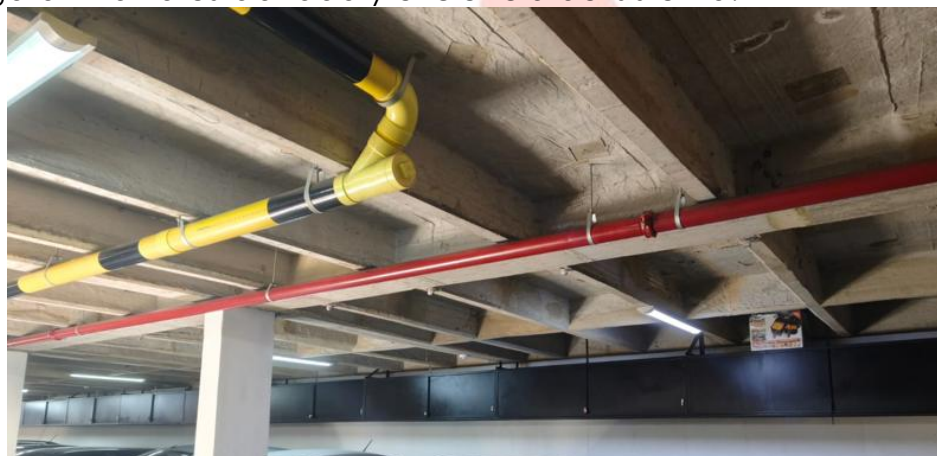
Imagen 2, red sin soportes antisísmicos
